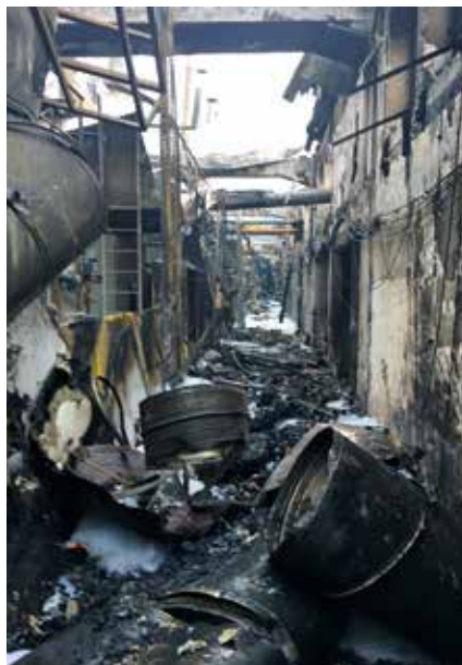
Die ausgebrannte Ofenhalle.
