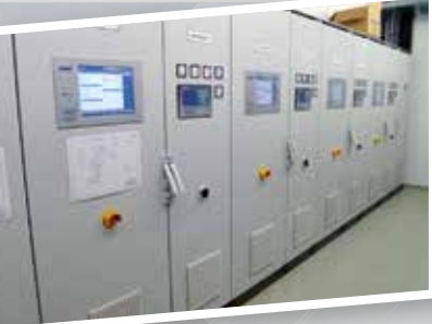
Schaltanlage für Blockheizkraftwerk
