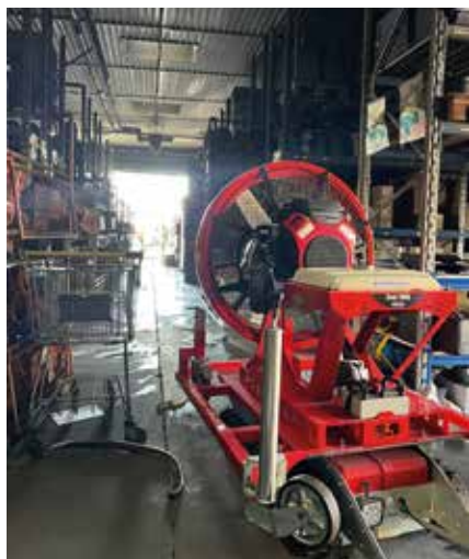
Einer unserer Großlüfter im Einsatz.
