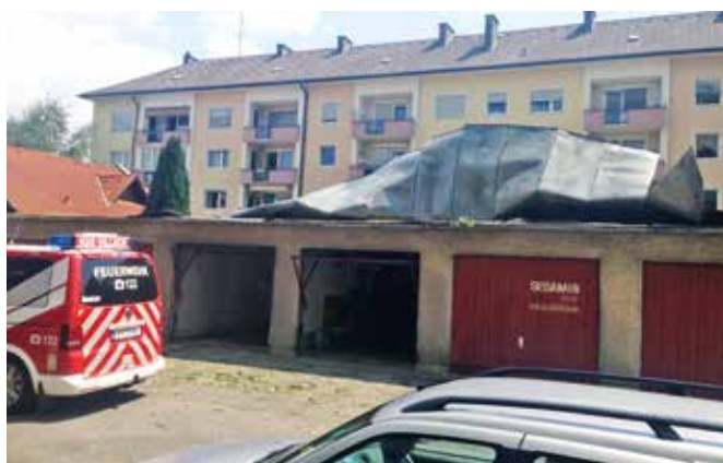
Ein losgerissenes Blechdach in einer Wohnanlage.
