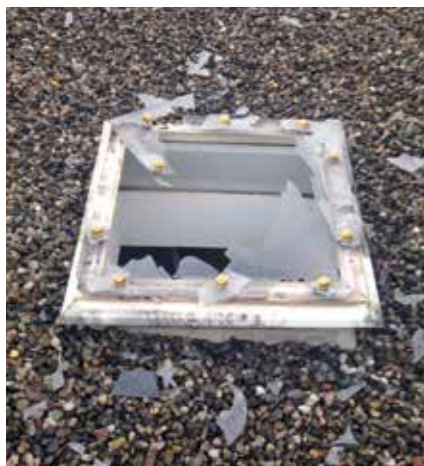
Unzählige Lichtkuppeln wurden durch den Hagel zerschlagen.
