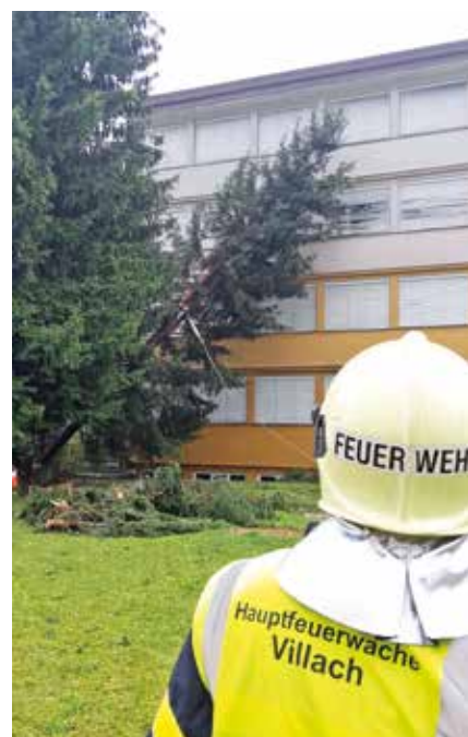
Bäume stürzten auf Häuser und beschädigten Fassaden.
